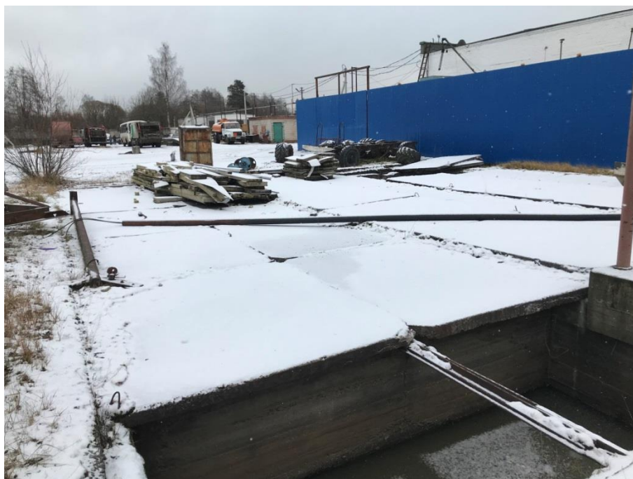
Фото 3. Отстойник ливневой системы канализации ООО «АВТОС»
